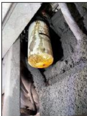
Fuite sur support de filtre à huile
